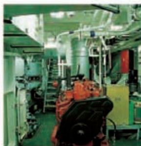
機関室 kikan shitsu engine room
